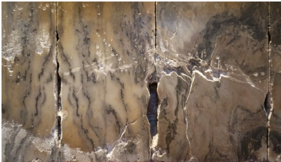
Interno della Basilica. Il degrado di un tratto di rivestimenti marmorei di Pavonazzetto
