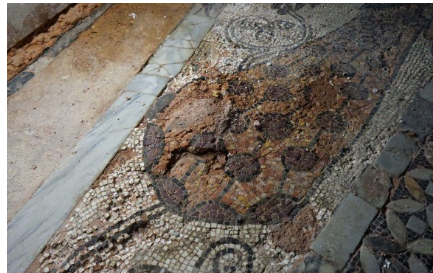
Interno della basilica. Dettaglio di un tratto danneggiato della decorazione musiva
