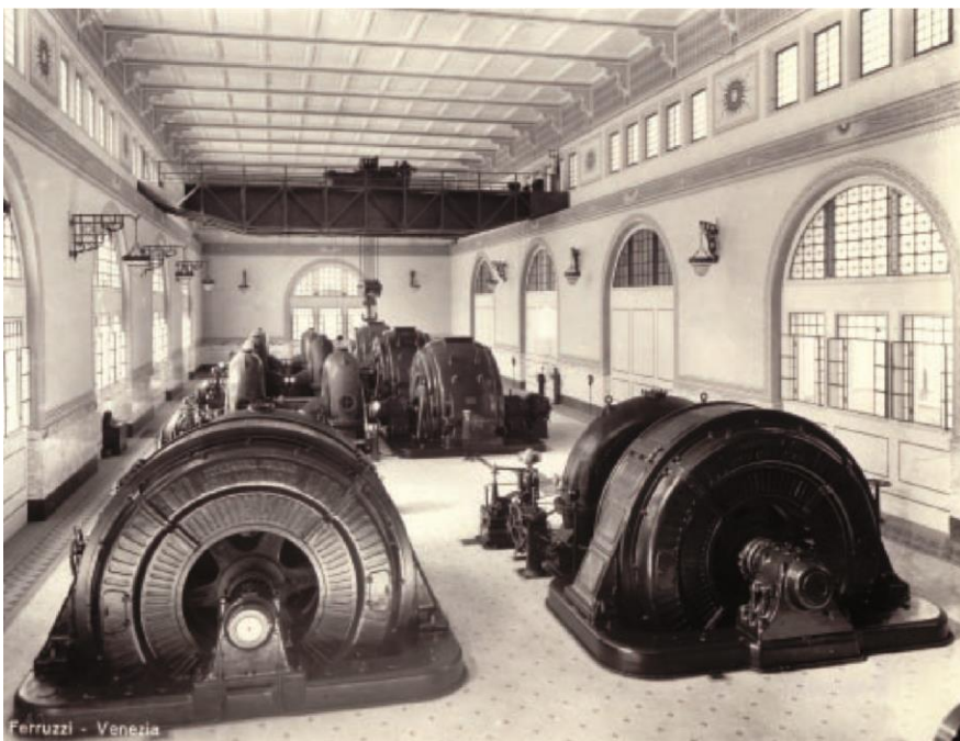
Figura 7. Assetto dei gruppi (3+2) di Nove 25 alla prima costruzione della centrale
