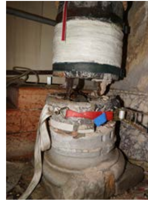
Figura 14 – Un fusto del portale di San Pietro in fase di sollevamento; sono visibili i perni metallici fortemente ossidati.
