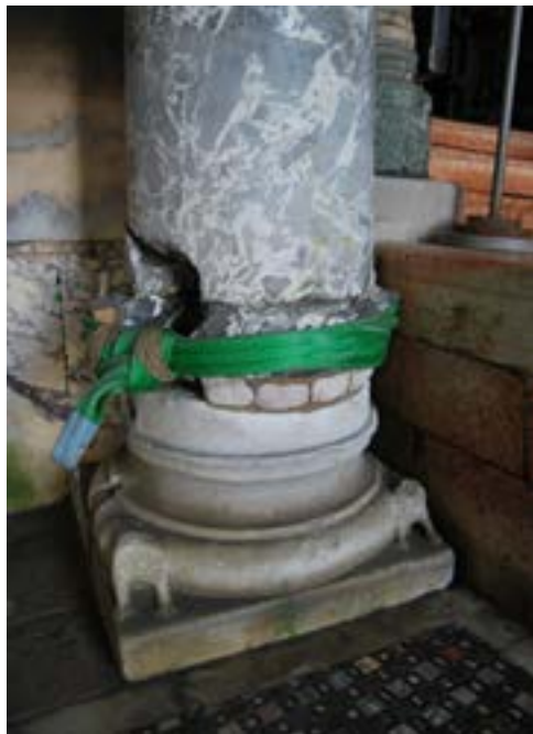
Figura 13 – Lo stato di dissesto del piede di una colonna del portale di San Pietro.
